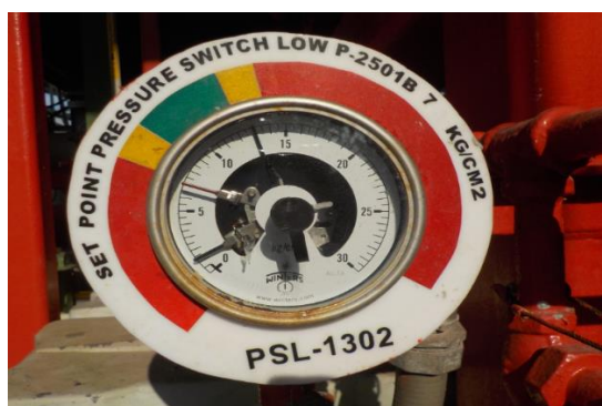
รูปที่ 4 เกจสำหรับตรวจสอบการตั้งค่าของสวิตช์ควบคุมความดัน
